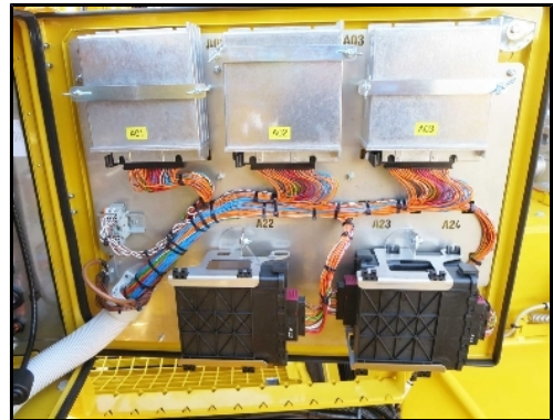
Deckel des Zentralelektrikschrank
