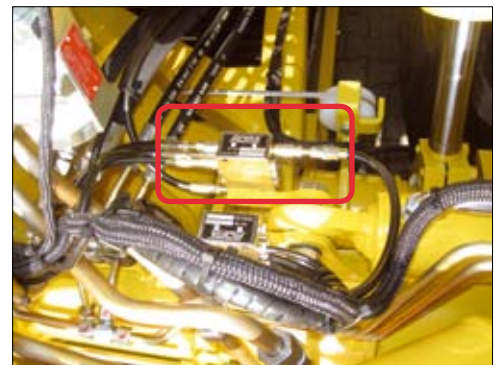
Hauptverteiler Roder und Schlegler.
