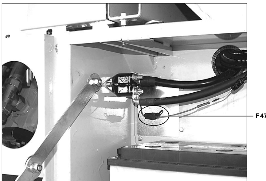
Sicherung F47 im Batteriekasten
