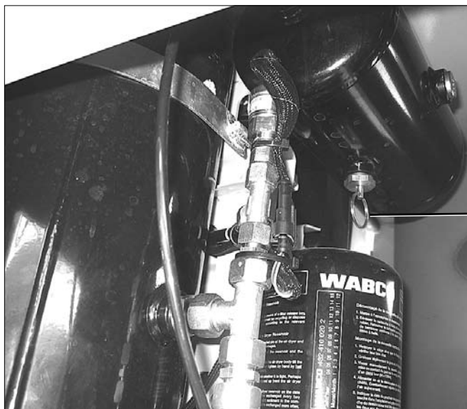
Ablassventil für Kondenswasser
