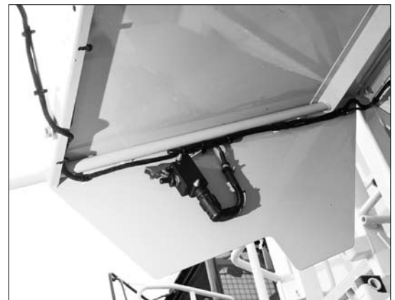
Stromversorgung am Notschalter abgeschaltet
