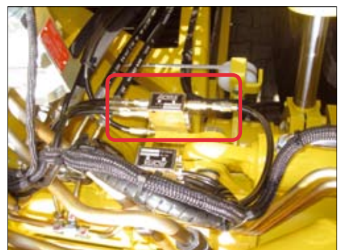
Hauptverteiler Roder und Schlegler.
