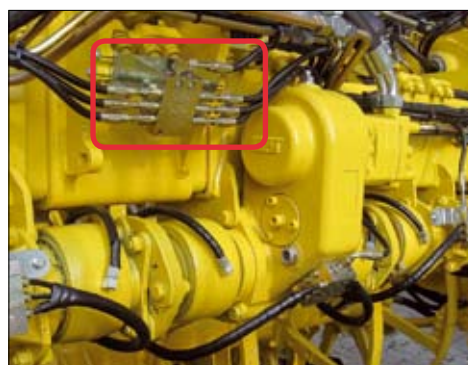
Hauptverteiler am Exzenterantrieb Rüttelschar.
